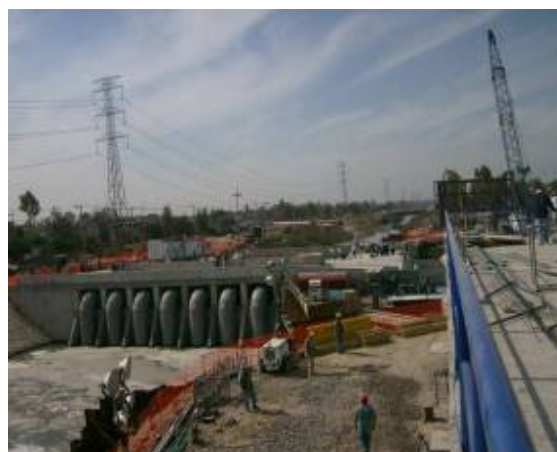
Planta de Bombeo Gran Canal km 11+600
