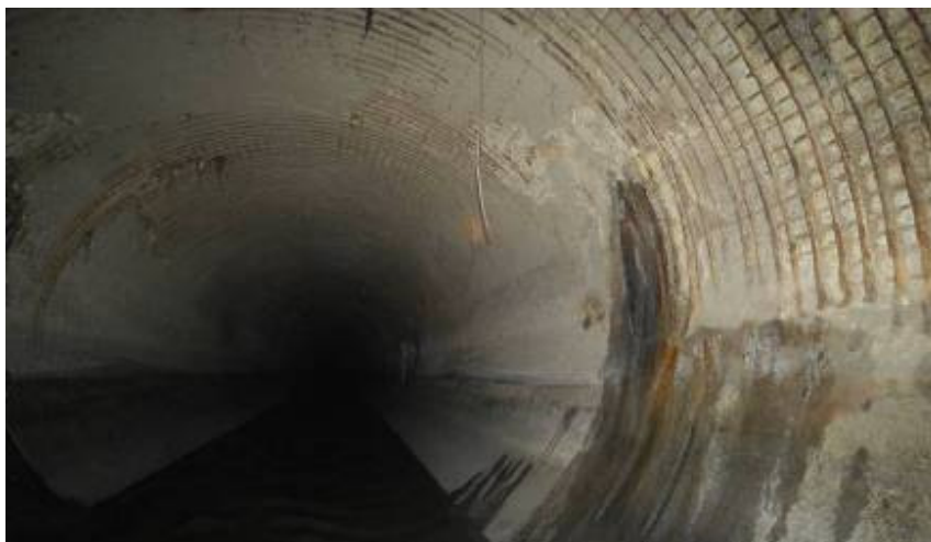
Condiciones del recubrimiento del Emisor Central.
